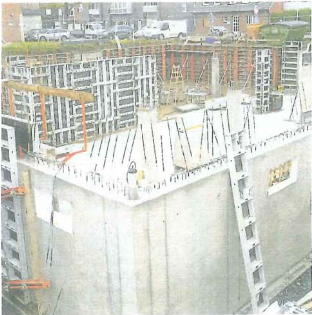
Baugrube statt Brache: So sieht es zurzeit an der Baustelle in Amelsbüren aus.
